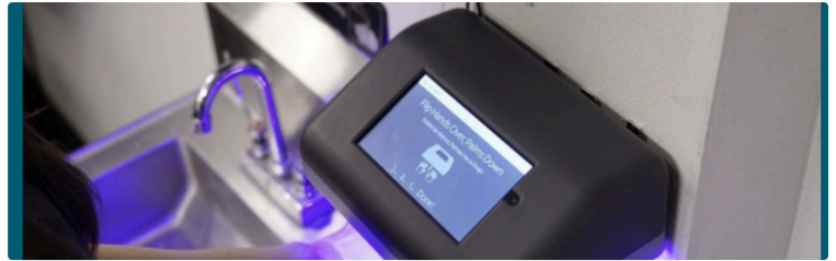
Estación HandScanner instalada junto al lavamanos
